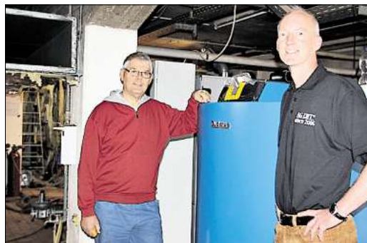
Werner Schmidt (links) und Badbetreiber Fred Oeltermann freuen sich über den neuen Kessel.
