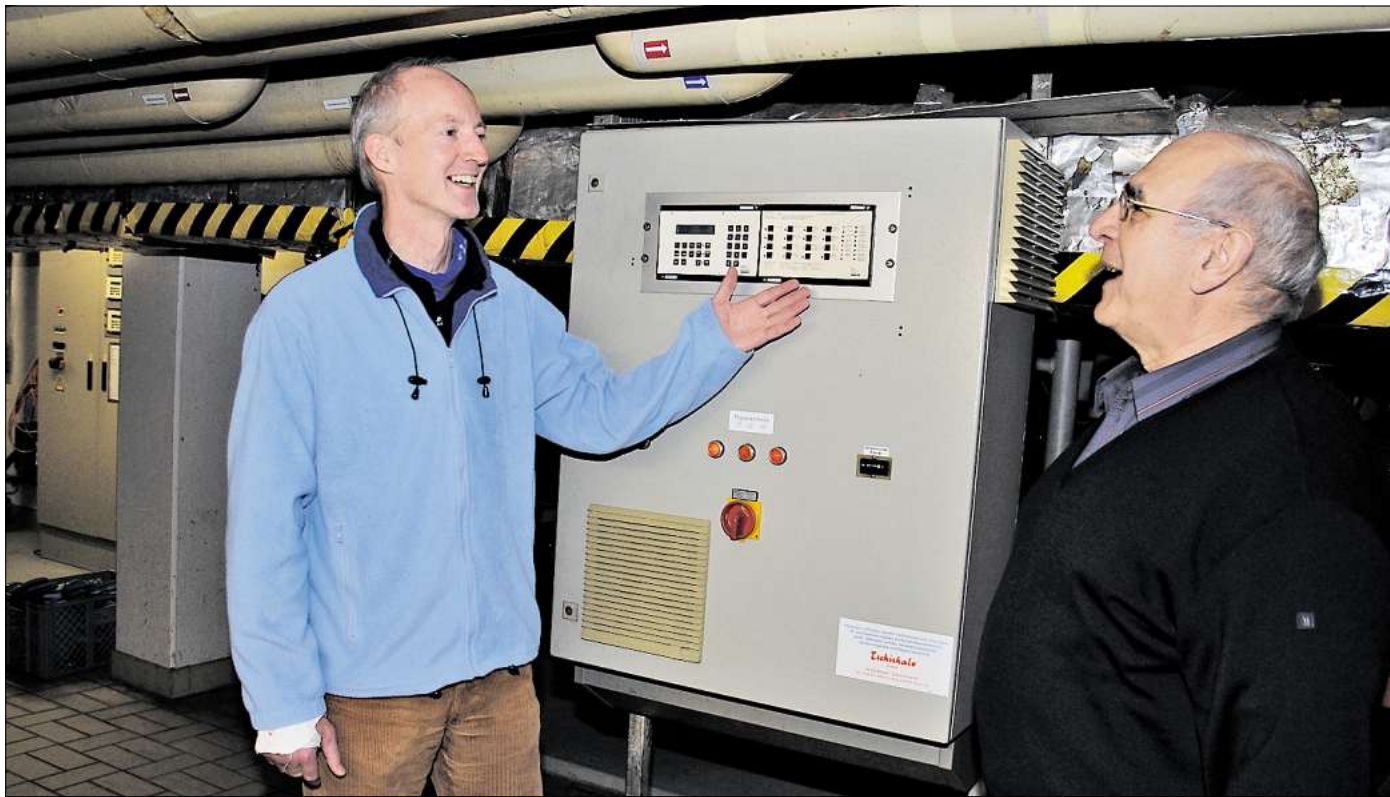
Badmanager Fred Oeltermann (links) und Fördervereinsvorsitzender Klaus-Dieter Theur freut es, dass die Steuerungsanlage der Heizung in diesem Jahr erneuert wird. Gallop (2)
