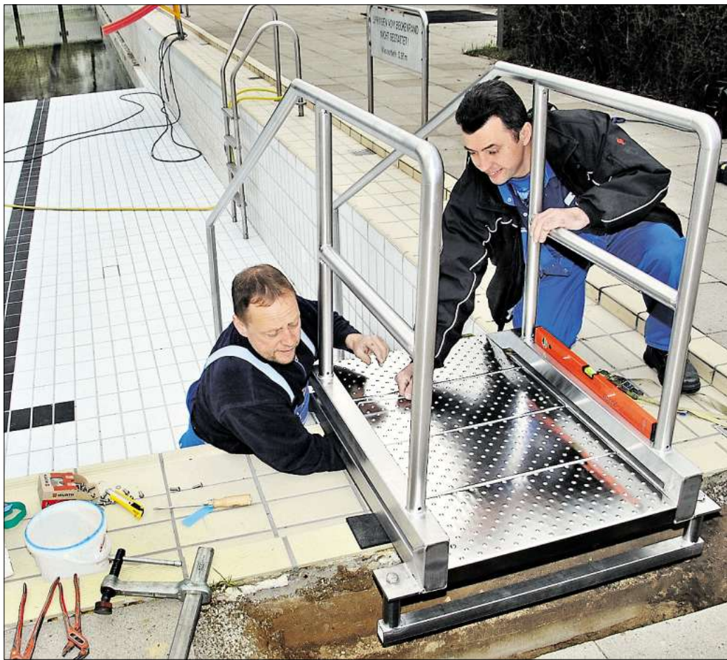
Fest und sicher: Uwe Held (links) und Nikolaj Lorov vom Stahl- und Metallbauer Riebensahm montieren die neue Edelstahlterrasse im Pattenser Freibad. Gallop
