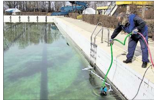
Badmitarbeiter Fredy Krüger holt aus dem Freibadbecken die Tauchpumpe hoch, die das Wasser während der kalten Monate in Bewegung hält. Caglar
