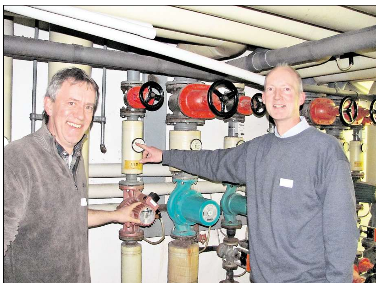
Uwe Hamerschmidt (links) und Fred Oeltermann vom Verein Rettungsring kümmern sich um die energieeffiziente Technik des Pattenser Bads.
